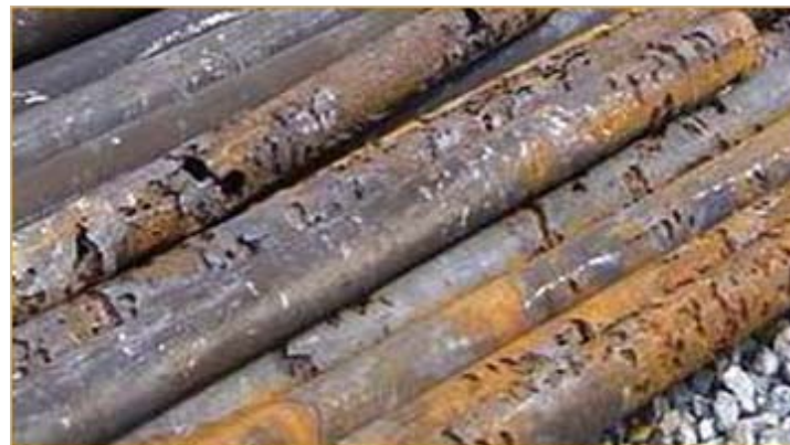
H 2 S引起硫化物应力腐蚀、氢脆、电化学腐蚀
